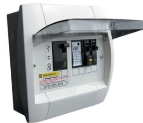
Paso 1 - Baje y suba el térmico del A/Ac para reiniciar la memoria de la PCB
